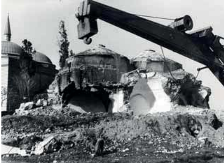
Fotoğraf 18 Murad Paşa Külliyesi'nin Hamamınının Yıkılması 115
